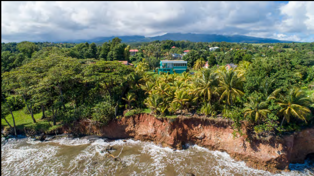
Erosion côtière - Guadeloupe - Décembre 2020
